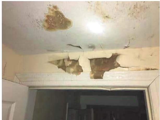
Paint peeling above door frame
