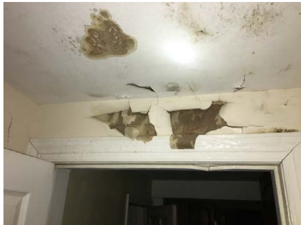
Paint peeling above door frame
