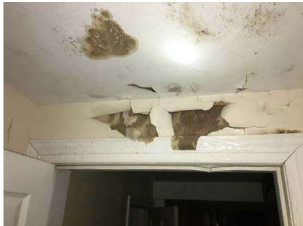
Paint peeling above door frame
